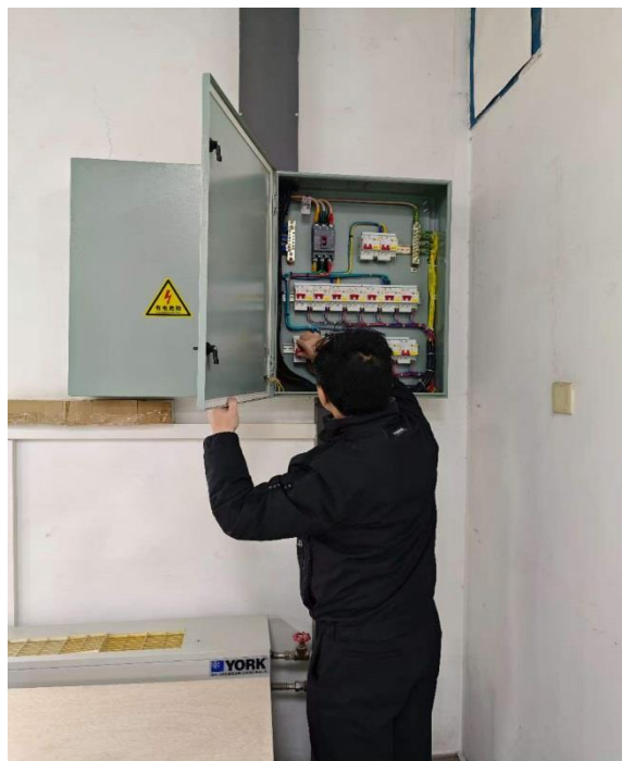
馆舍水电线路
