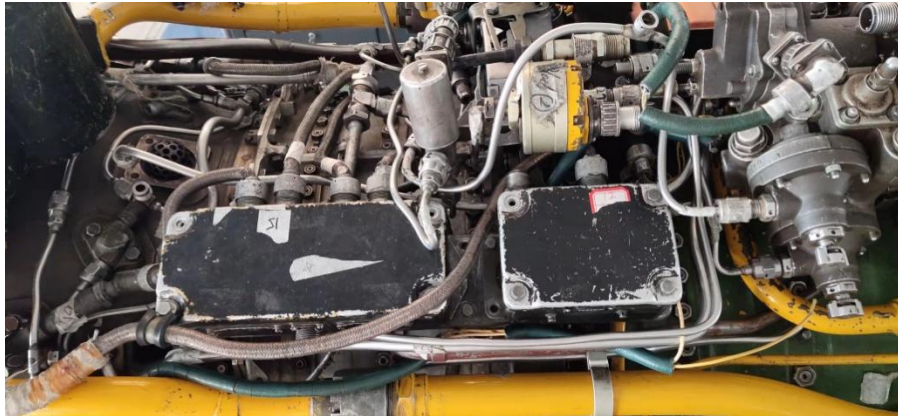
点火装置安装部位
