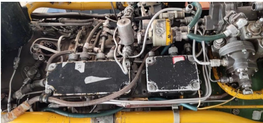
原涡喷 6 点火装置安装固定方式图片
